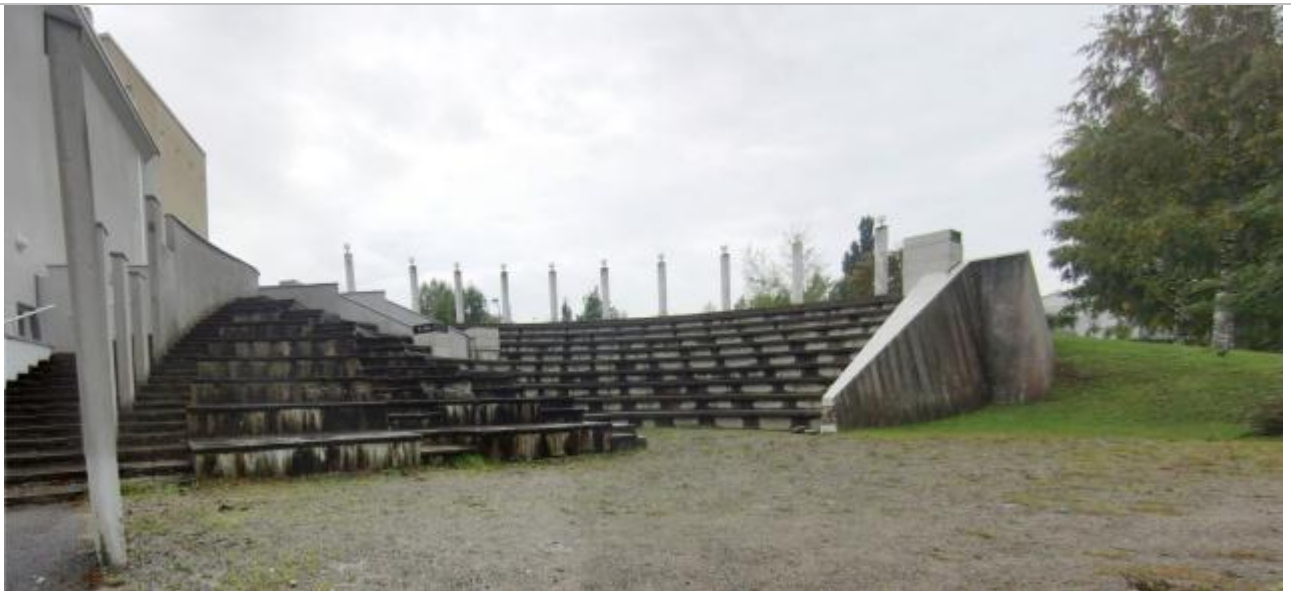
kuva: Rakennuksen kulmalla oleva amfiteatteri yhdistää etu- ja takapihan. Rakenteet ovat sään vaurioittamat.
