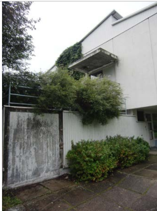
kuva: Rakennuksen julkisivupinnat ovat paikoin rapistuneet.
