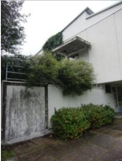
kuva: Seurakuntakeskuksen rakennus on osittain kulunut.
