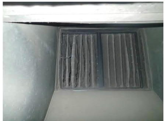
Kuva 34. Korvausilmakanavan karkea-vissa epäpuhtauksia, maa-ainesta ja vet-suodatin sekä kanaviston seinämät todet-tiin todella pölyiseksi ja osittain tukkeen-tuneeksi.
