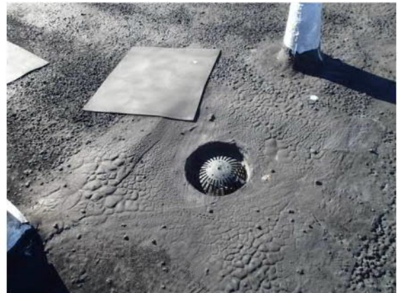
Kuva 28. Sadevesiviemäri on useita senttejä koholla muuhun vesikattoon nähden.
