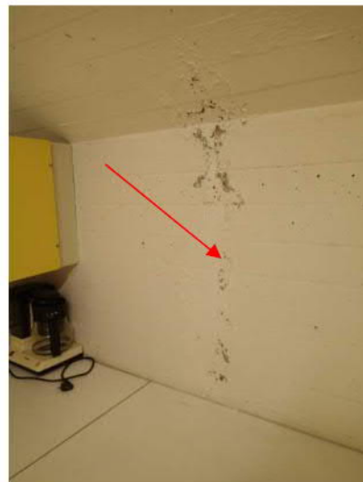
Kuva 5. Arkiston alapohjan raken- Kuva 6. Väestönsuojan perusmuurissa neavauksessa pohjaveden pinta havaittiin oleva kosteusjälki, joka on lähtöisin välipohjan tekniikkakanaalista.
