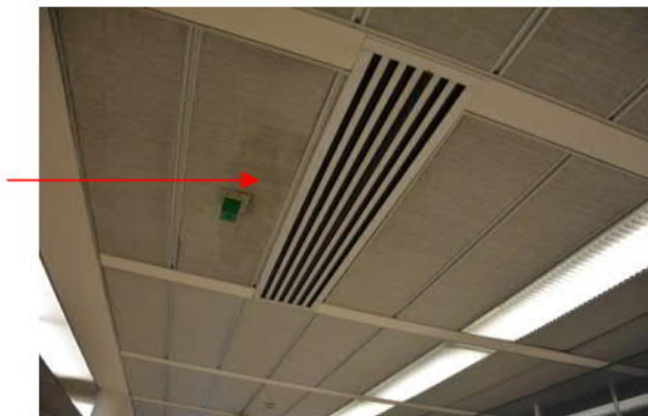
Kuva 29. Sisäkattolevyissä olevia kosteusjälkiä
