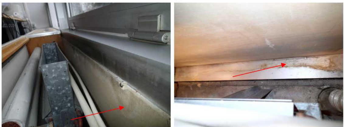
Kuvat 6 ja 7. Ulkoseinien sisä- ja ulkopuolissa kovalevyissä sekä alumiinielementin
