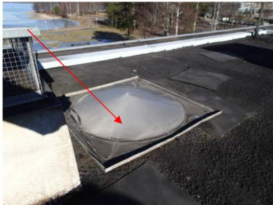
Kuva 27. Vesikatolla olevia irtonaisia piipunhattuja.
