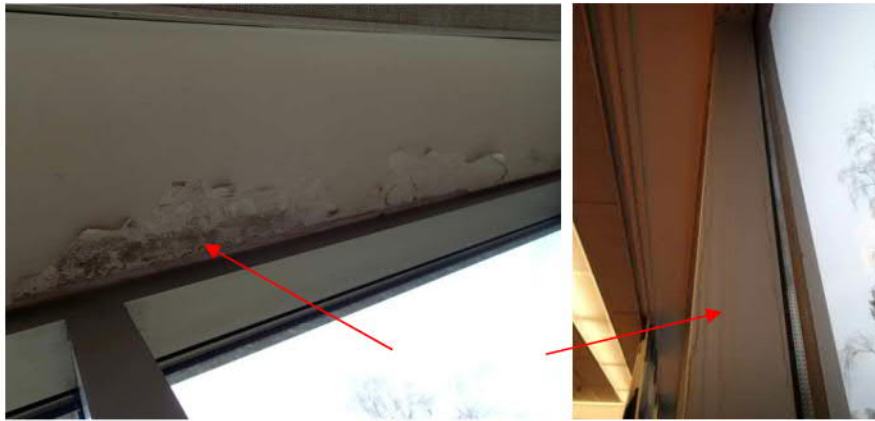
Kuvat 14 ja 15. Betonipalkissa havaittavissa kalkkihärmettä ja irronnutta pinnoitetta. Ikkunan puitteessa näkyvissä veden valumajälkiä.
