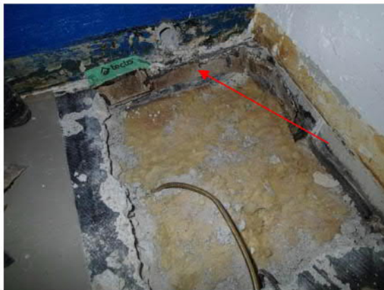
Kuva 16. Kellarin alapohjan ja perusmuurin välissä oleva paperinen valunero-tuskaista.
