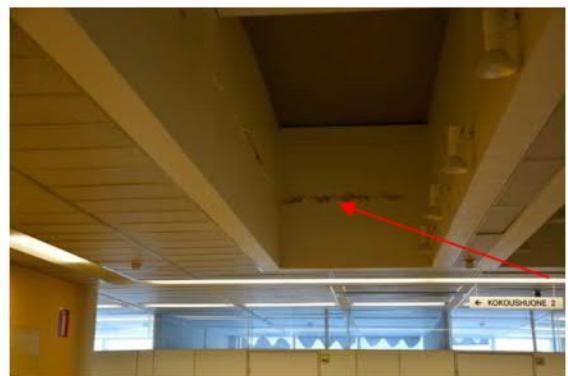
Kuva 30. Kattoikkunoiden syvennyksessä betonirakenteissa olevia kosteusjälkiä.
