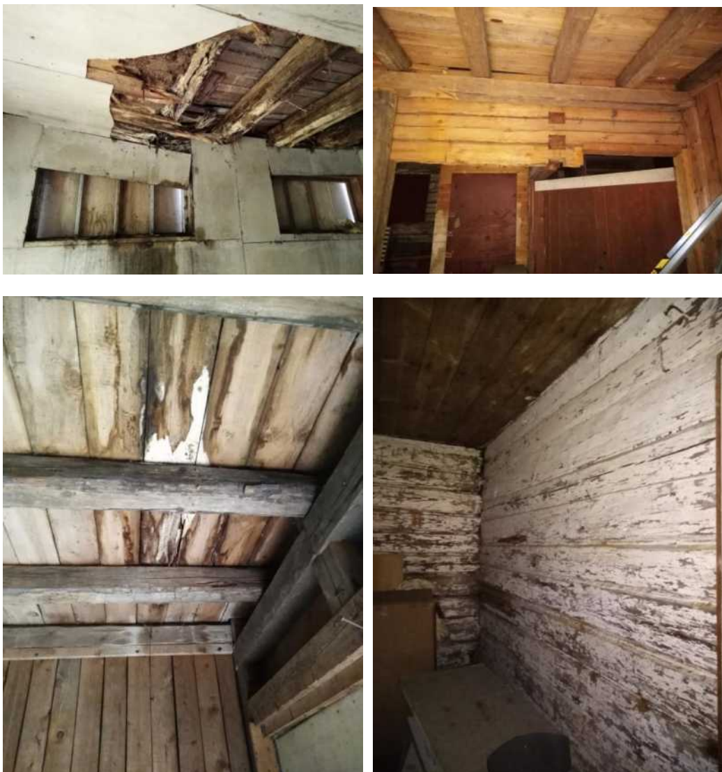
Kuva 37. Sisätilojen kosteusvaurioita ja rakenteita.
