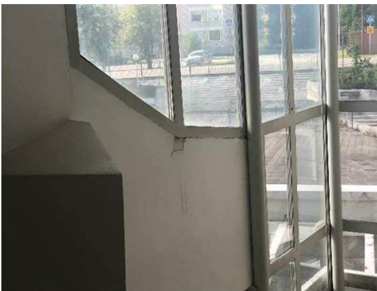
Kuva 11 Aulassa kiinteitä alumiini-ikkunoita, sisäpuolella vuotojälkiä
