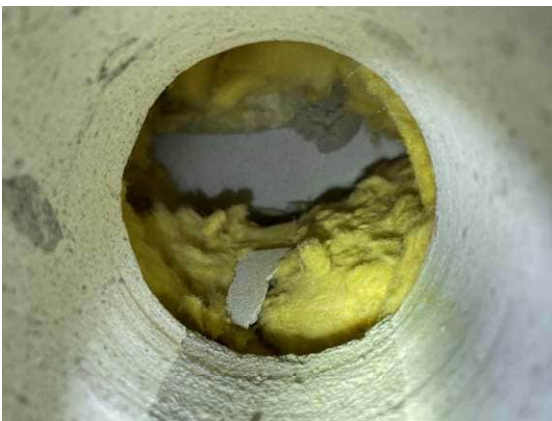
Kuva 34 RA11, lämmöneristeenä mineraalivillaa, tuuletusrako puuttuu
