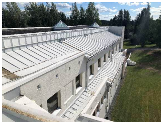
Kuva 14 Vinot osat toteutettu peltikatteella, pelleissä ruostumaa
