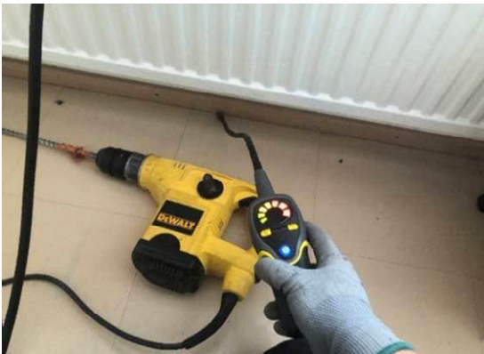
Kuva 50 Merkittävää ilmavuotoa tilan 2003 US ja VP liitoksesta
