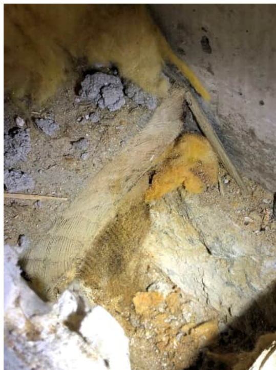
Kuva 30 RA8, sokkelihalkaisun puurunko lahonnut ja märkä
