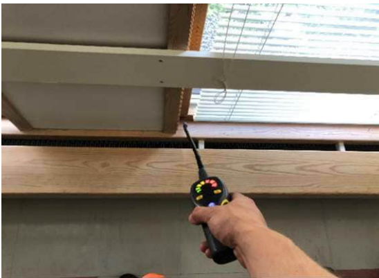
Kuva 44 Merkittävää ilmavuotoa tilan 0044 karmiliitoksesta
