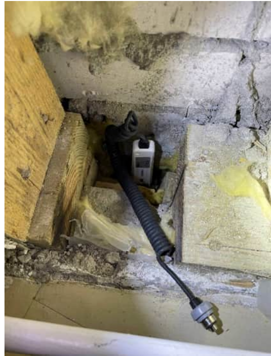
Kuva 37 RA16, sokkelin lämmöneristeenä mineraalivilla
