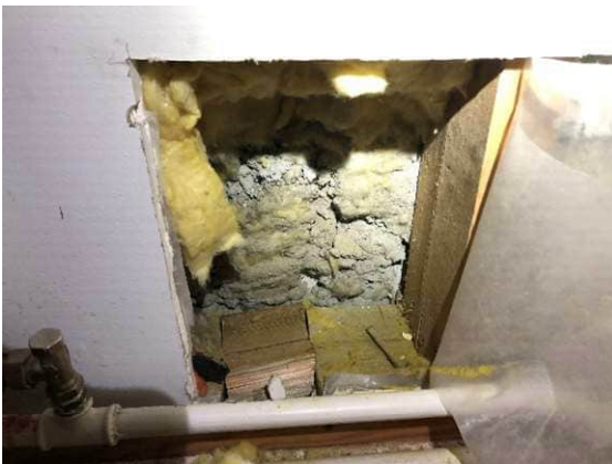
Kuva 38 RA17, tuuletusrako täynnä laastipurseita
