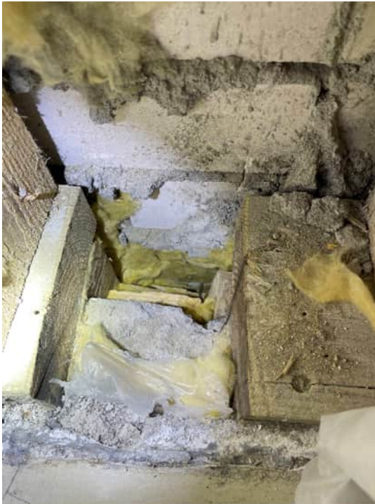
Kuva 36 RA16, tuuletusrako tukossa laastipurseista
