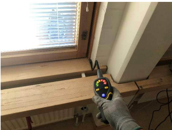
Kuva 52 Merkittävää ilmavuotoa tilan 2008 ulkoseinän ja ikkunan liitoksesta
