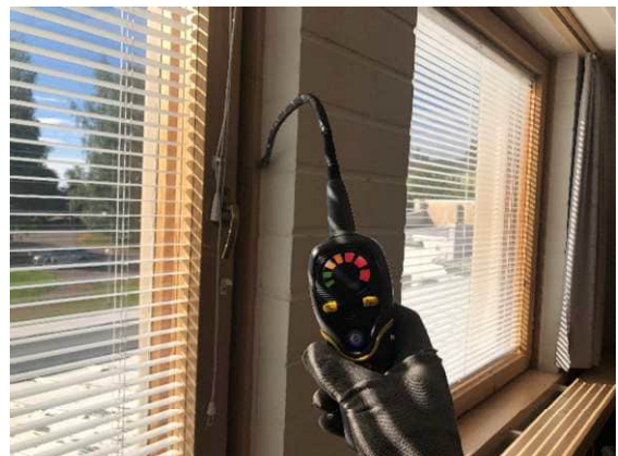
Kuva 53 Merkittävää ilmavuotoa tilan 2028 ikkunan ja ulkoseinän liitoksesta
