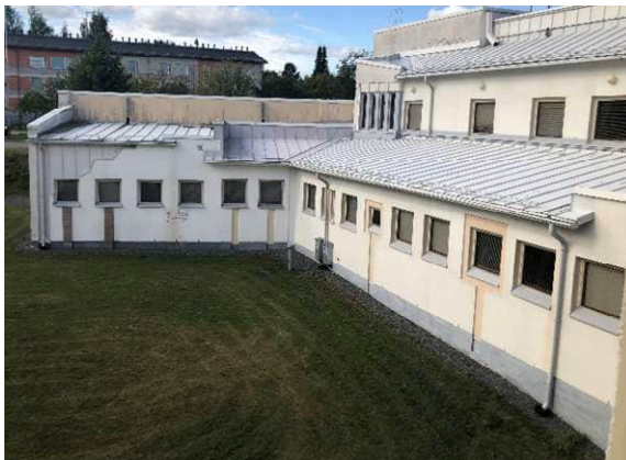
Kuva 7 Yleiskuva julkisivusta, julkisivu rapattu, rappauksessa runsaasti vaurioita
