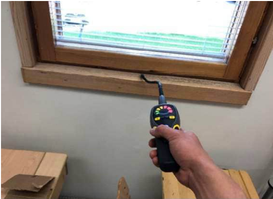
Kuva 42 Merkittävää ilmavuotoa tilan 0052 ikkunan ja ulkoseinän liitoksesta
