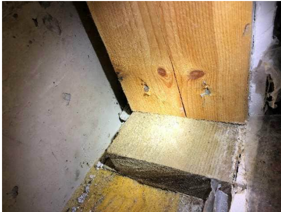
Kuva 40 RA18, rungon takana tuuletusrako, mineraalivillaläpän kiinnitys betonissa
