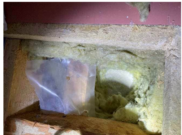
Kuva 26 RA7, mineraalivillan alla betonilaatta
