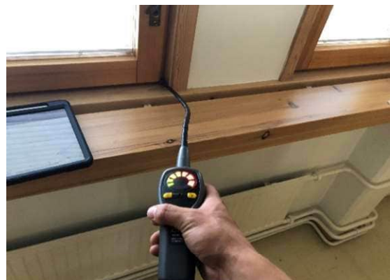
Kuva 47 Merkittävää ilmavuotoa tilan 1028 ikkunan ja ulkoseinän liitoksesta
