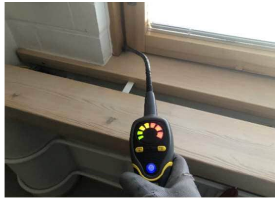
Kuva 51 Merkittävää ilmavuotoa tilan 2021 karmiliitoksesta
