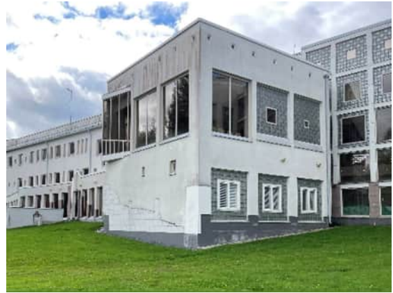
Kuva 10 Julkisivussa runsaasti vaurioita ja valumajälkiä
