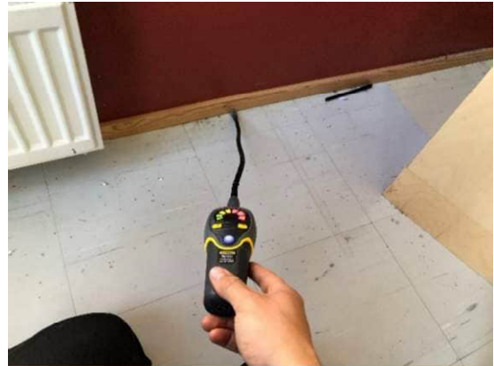
Kuva 49 Merkittävää ilmavuotoa tilan 1104 alapohjan ja ulkoseinän liitoksesta
