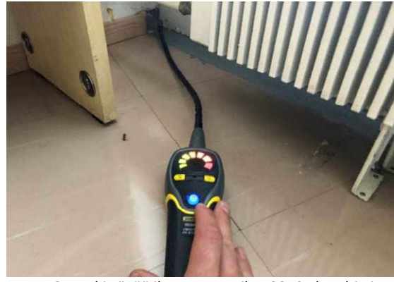
Kuva 43 Merkittävää ilmavuotoa tilan 0050 alapohja ja ulkoseinän liitoksesta
