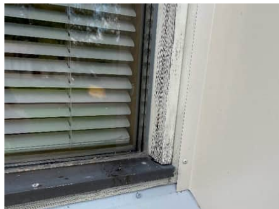
Kuva 12 Puuikkunat pääosin MSE-ikkunoita, ulkopuolen maalipinta huonossa kunnossa
