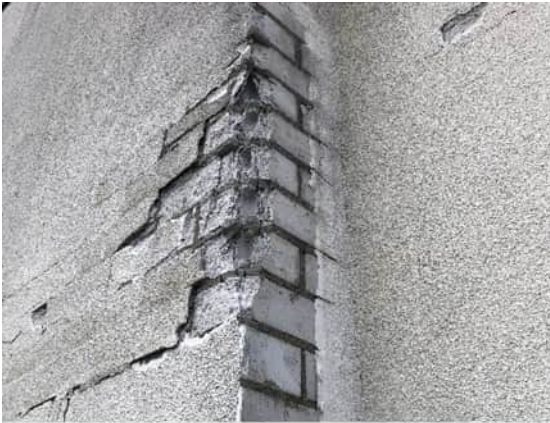
Kuva 9 Rappaus laajalti vaurioitunut
