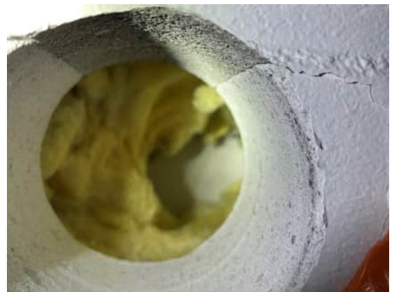
Kuva 35 RA12, lämmöneristeenä mineraalivillaa, tuuletusrako puuttuu
