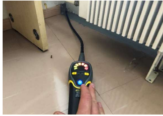
Kuva 43 Merkittävää ilmavuotoa tilan 0050 alapohja ja ulkoseinän liitoksesta
