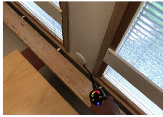
Kuva 45 Merkittävää ilmavuotoa tilan 0053 seinän läpiviennistä
