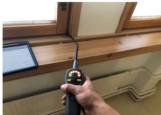
Kuva 47 Merkittävää ilmavuotoa tilan 1028 ikkunan ja ulkoseinän liitoksesta
