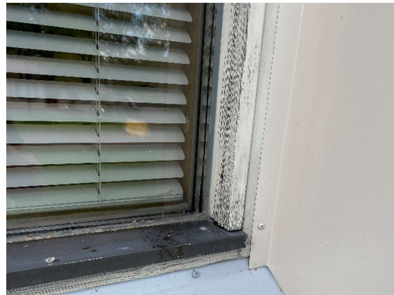
Kuva 12 Puuikkunat pääosin MSE-ikkunoita, ulkopuolen maalipinta huonossa kunnossa
