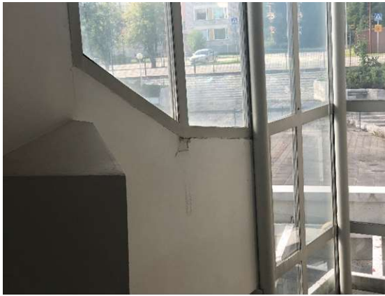
Kuva 11 Aulassa kiinteitä alumiini-ikkunoita, sisäpuolella vuotojälkiä
