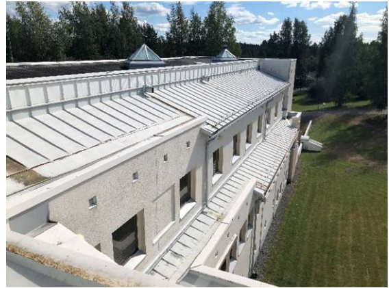
Kuva 14 Vinot osat toteutettu peltikatteella, pelleissä ruostumaa
