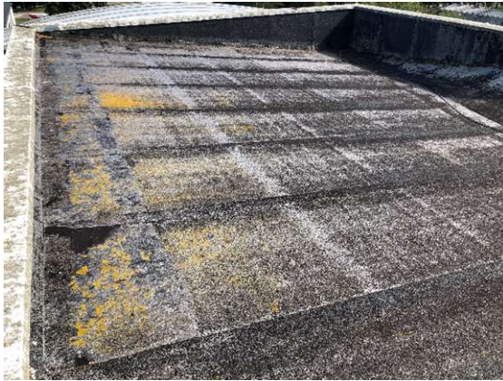
Kuva 13 Kermikate erittäin huonossa kunnossa, aluskangas näkyvissä ja kate on sammaloitunut
