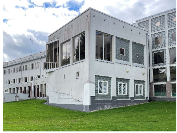
Kuva 10 Julkisivussa runsaasti vaurioita ja valumajälkiä
