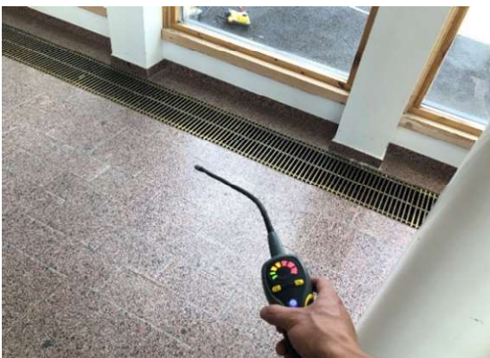
Kuva 46 Tilassa 1088 merkittävää ilmavuotoa, tila täyttyi merkkiainekaasulla
