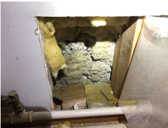
Kuva 38 RA17, tuuletusrako täynnä laastipurseita
