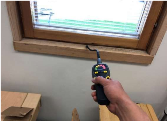
Kuva 42 Merkittävää ilmavuotoa tilan 0052 ikkunan ja ulkoseinän liitoksesta
