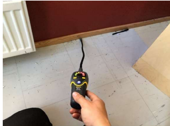
Kuva 49 Merkittävää ilmavuotoa tilan 1104 alapohjan ja ulkoseinän liitoksesta
