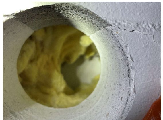
Kuva 35 RA12, lämmöneristeenä mineraalivillaa, tuuletusrako puuttuu
