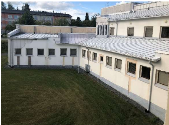
Kuva 7 Yleiskuvaa julkisivusta, julkisivu rapattu, rappauksessa runsaasti vaurioita
