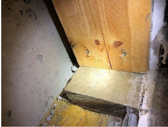
Kuva 40 RA18, rungon takana tuuletusrako, mineraalivillaläpiste paikoin kiinni betonissa
