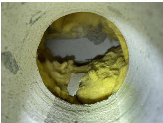
Kuva 34 RA11, lämmöneristeenä mineraalivillaa, tuuletusrako puuttuu
