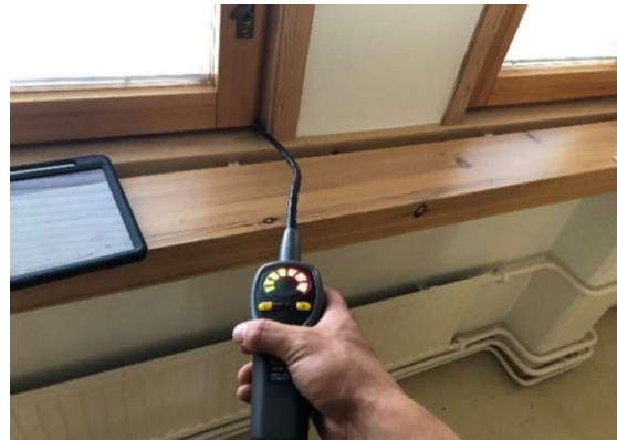
Kuva 47 Merkittävää ilmavuotoa tilan 1028 ikkunan ja ulkoseinän liitoksesta
