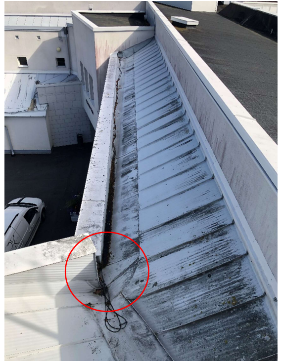
Kuva 16 Vedenpoisto toteutettu monimutkaisesti ja sisäpuolisella vedenpoistolla
