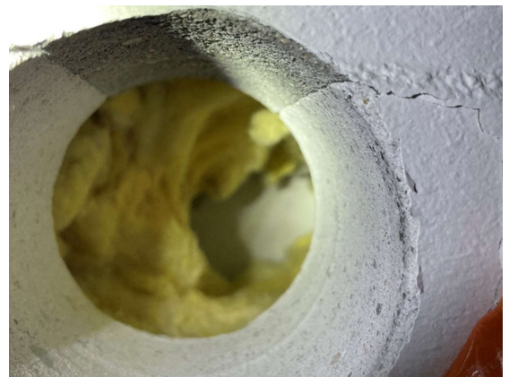
Kuva 35 RA12, lämmöneristeenä mineraalivillaa, tuuletusrako puuttuu
