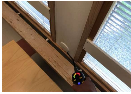
Kuva 45 Merkittävää ilmavuotoa tilan 0053 seinän läpiviennistä
