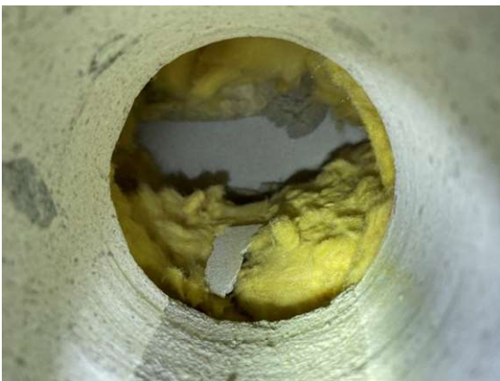
Kuva 34 RA11, lämmöneristeenä mineraalivillaa, tuuletusrako puuttuu
