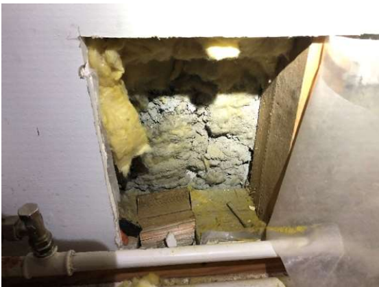
Kuva 38 RA17, tuuletusrako täynnä laastipurseita
