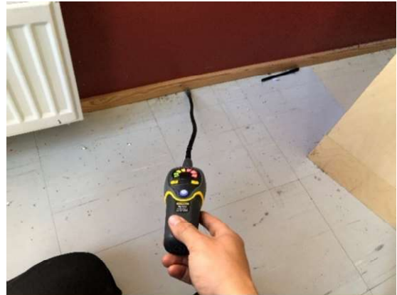
Kuva 49 Merkittävää ilmavuotoa tilan 1104 alapohjan ja ulkoseinän liitoksesta
