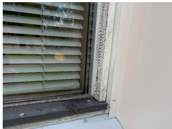
Kuva 12 Puuikkunat pääosin MSE-ikkunoita, ulkopuolen maalipinta huonossa kunnossa
