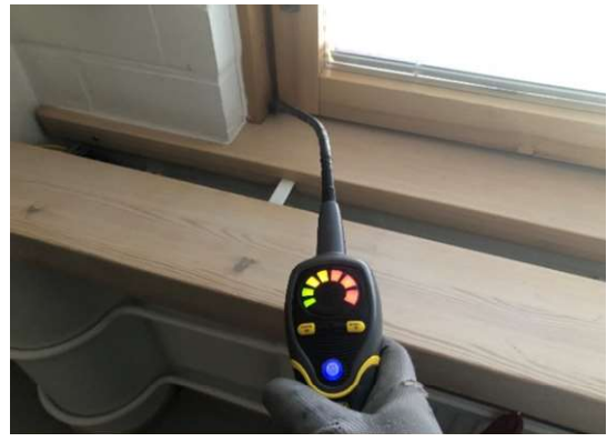
Kuva 51 Merkittävää ilmavuotoa tilan 2021 karmiliitoksesta
