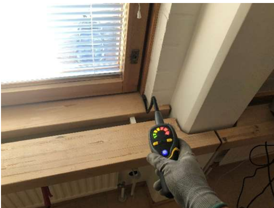
Kuva 52 Merkittävää ilmavuotoa tilan 2008 ulkoseinän ja ikkunan liitoksesta
