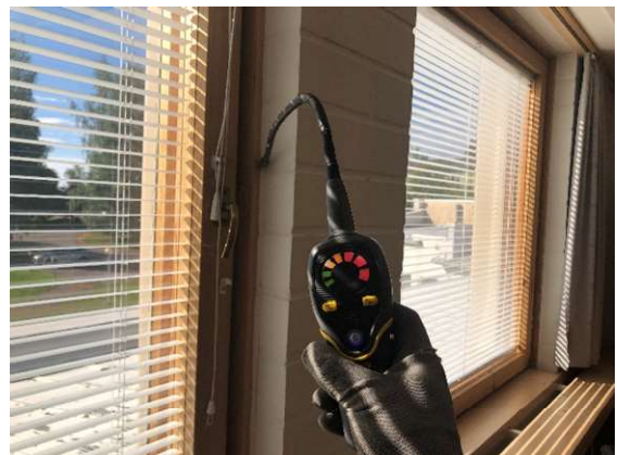
Kuva 53 Merkittävää ilmavuotoa tilan 2028 ikkunan ja ulkoseinän liitoksesta
