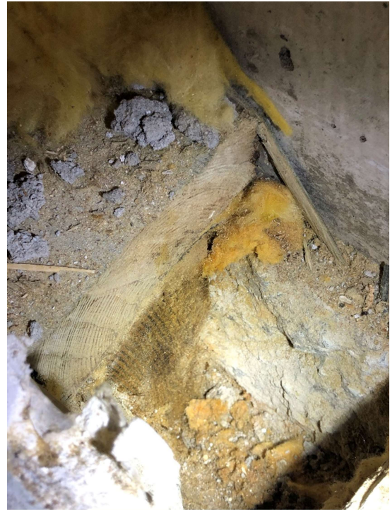
Kuva 30 RA8, sokkelihalkaisun puurunko lahonnut ja märkä
