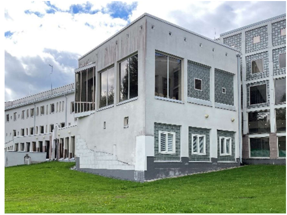
Kuva 10 Julkisivussa runsaasti vaurioita ja valumajälkiä
