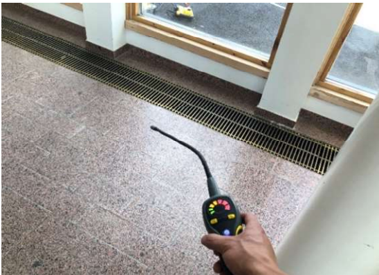
Kuva 46 Tilassa 1088 merkittävää ilmavuotoa, tila täyttyi merkkiainekaasulla
