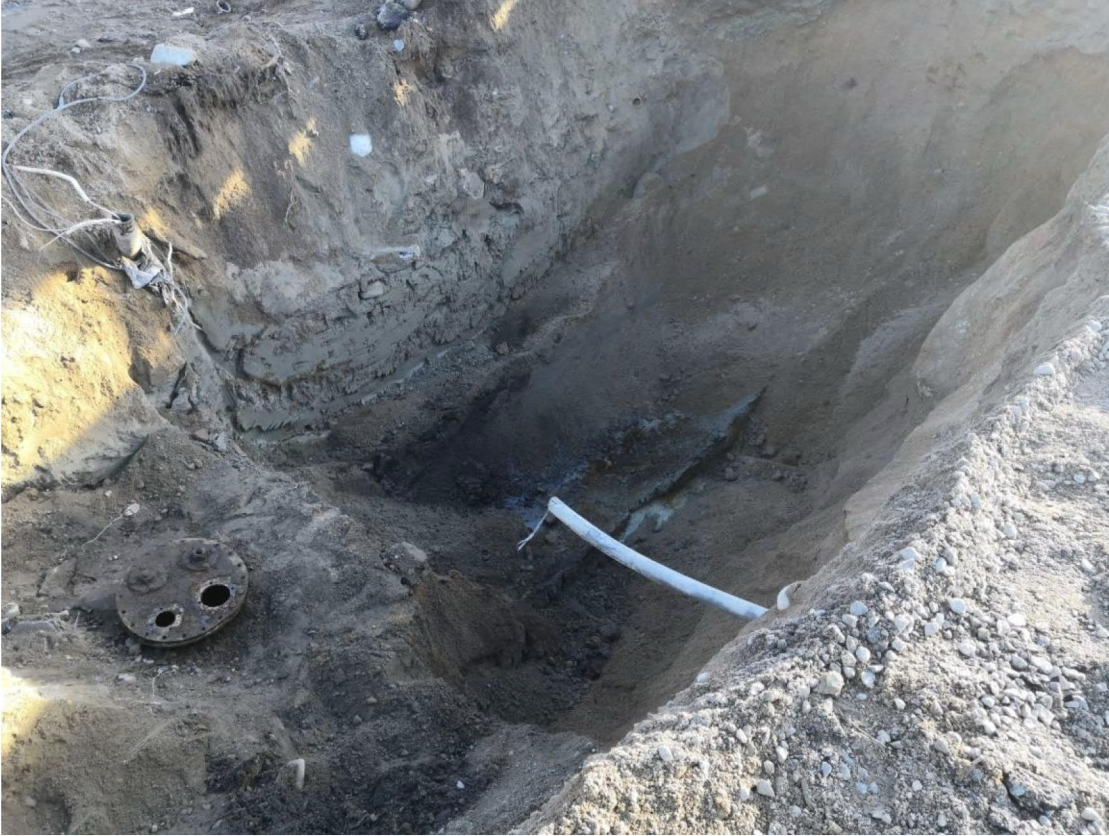
Kuva 3. Poistetun polttoainesäiliön pohja, jossa havaittiin bensiinin hajua
