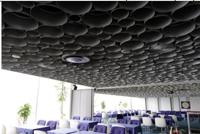
Ruokasalin katto on toteutettu alumiiniputkista, joihin tekniikka on piilotettu.
